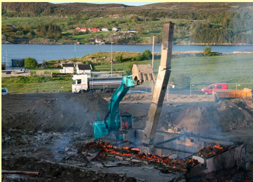
Kl. 21:09 - huset har brunne ned til grunnen og pipa går i bakken, 1 time og 41 min. etter at den første flammen viste seg på utsida av huset.
